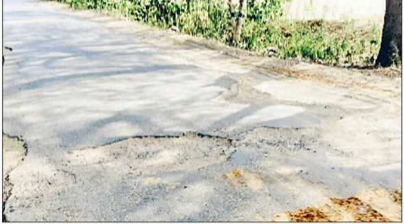
कनीना। कनीना महेंद्रगढ़ स्टेट हाईवे से गुढ़ा को लिंक करने वाली टूटी सड़क।
